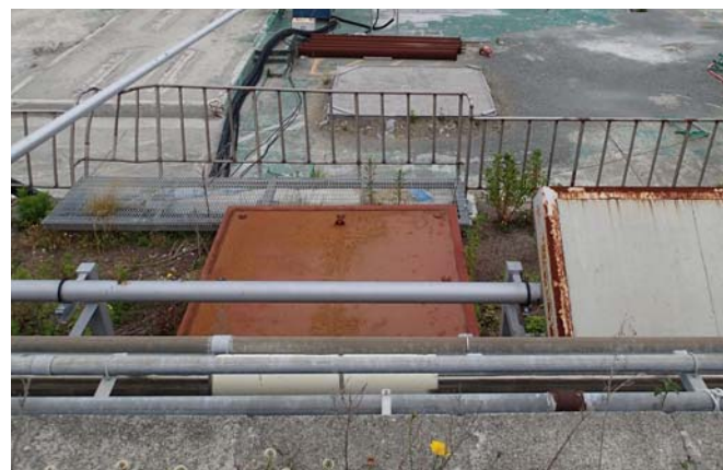
3号機 海側立坑閉塞状況
