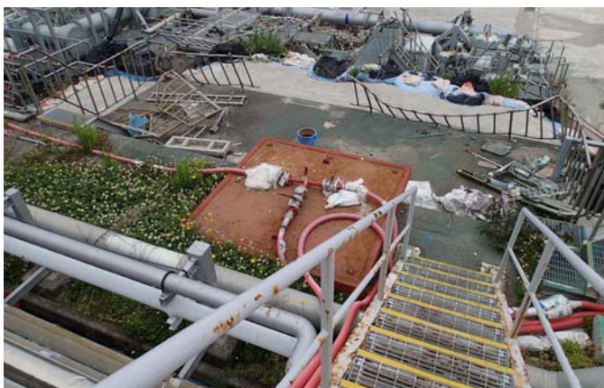
2号機 海側立坑閉塞状況
