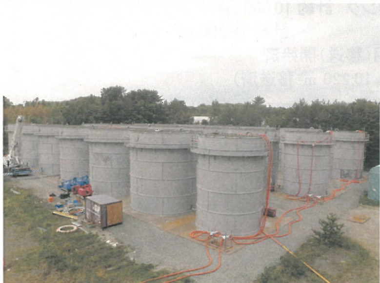
撮影:東京電力株式会社 撮影日:平成23年5月27日15:00頃 場所:貯蔵所(北側) ③丸型タンク(配置図参照)
