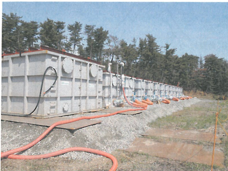
撮影:東京電力株式会社 撮影日:平成23年5月4日9:30頃 場所:貯蔵所(北側) ①角型タンク(配置図参照)
