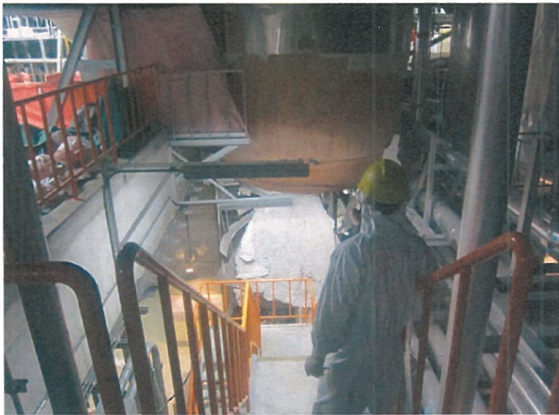
湿分分離器底部
