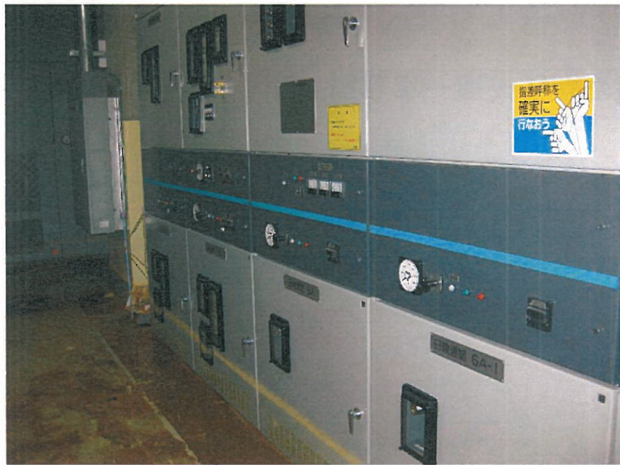
6.9kV スイッチギア室
