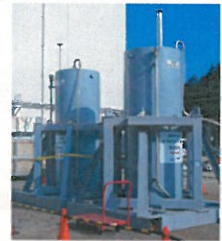
自立架台に置かれた SARRY吸着塔
