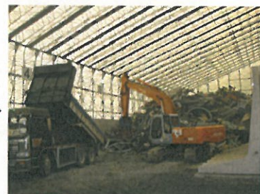
テント内がれき収集状況
