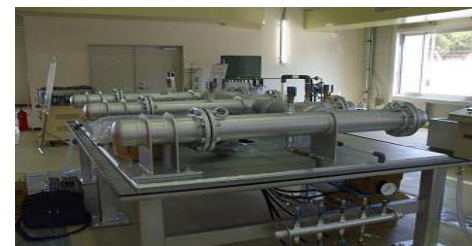
フランジからの漏水防止
