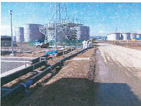
各系統から一時貯留タンクへ向かう移送配管
