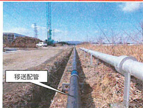
A系統から一時貯留タンクへ向かう移送配管
