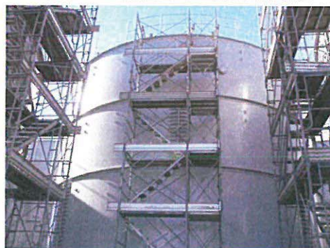
一時貯留タンク
