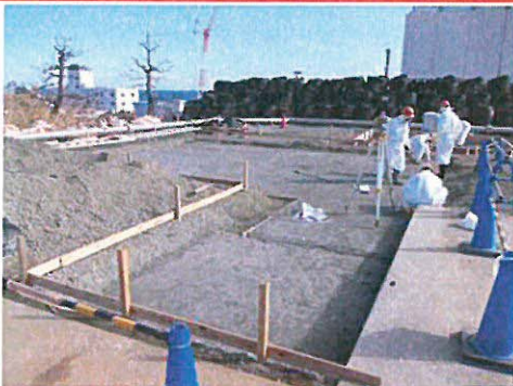
A系統バッファタンク設置状況
