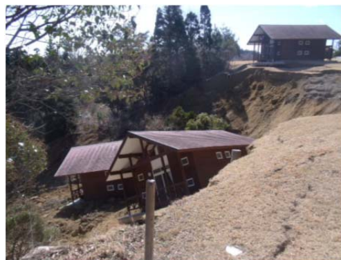
いわき海浜自然の家 法面崩落 ロッジ倒壊(H23.3.20)
