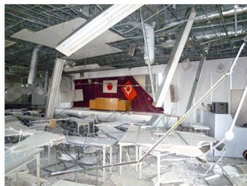
教育センター 5 階 講堂の天井崩落の様子
