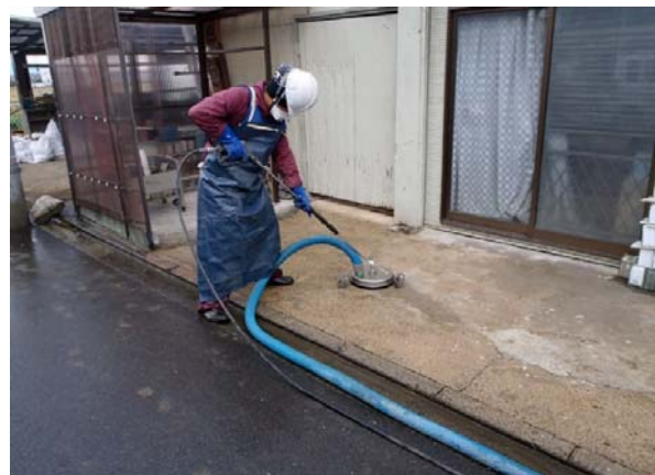
吸引型高圧洗浄によるコンクリートたたき等の除染作業
