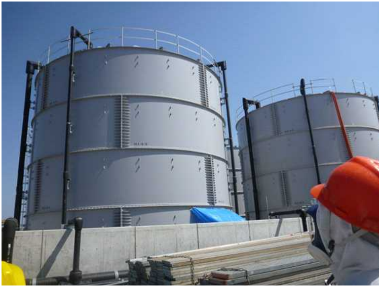
○多核種除去設備（ALPS） サンプルタンク
