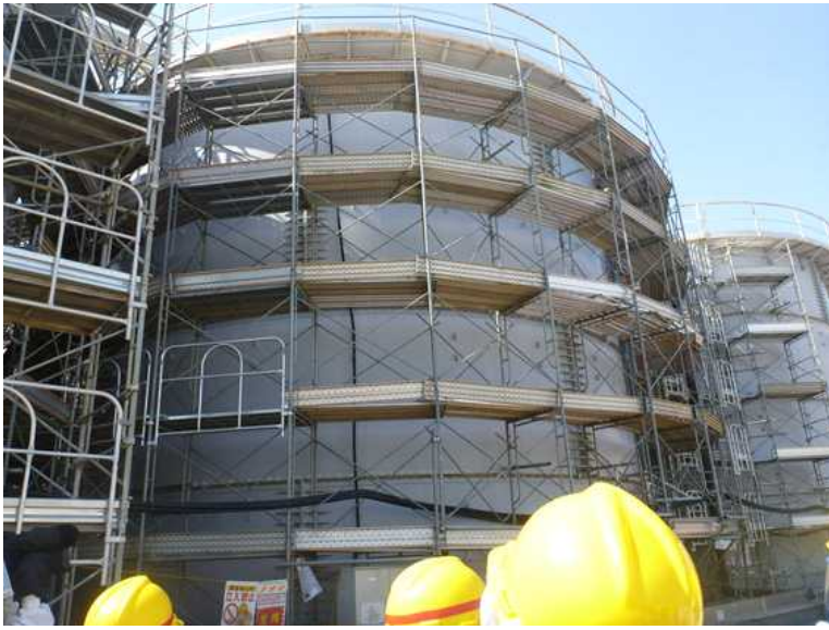
○ H6 タンクエリア 汚染水漏えいタンク
