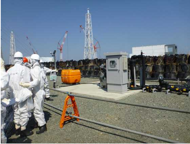
○地下水バイパス No.12 揚水井・揚水ポン プ
