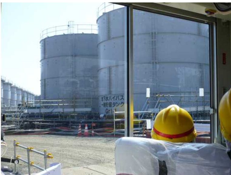
○地下水バイパス 一時貯留タンク
