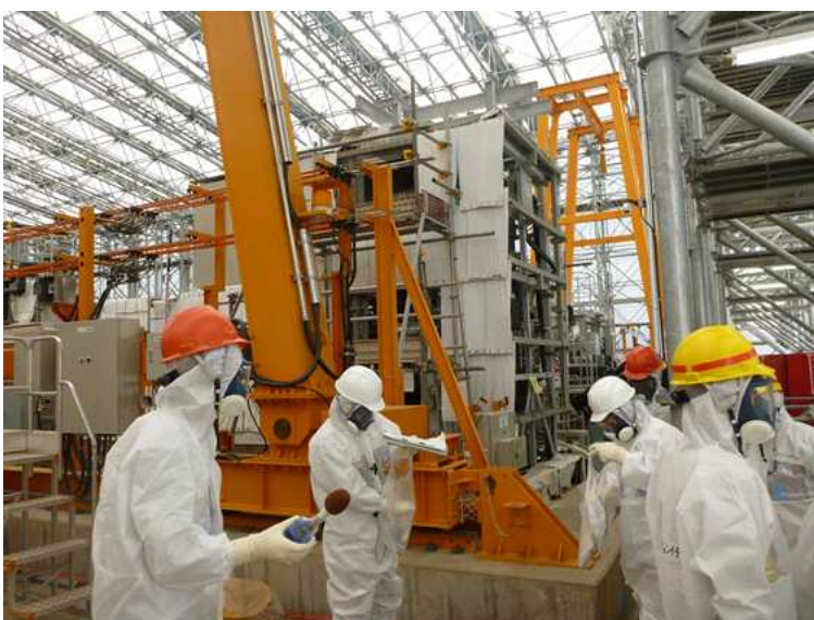
○多核種除去設備（ALPS） クロスフローフィルタ（C） 系
