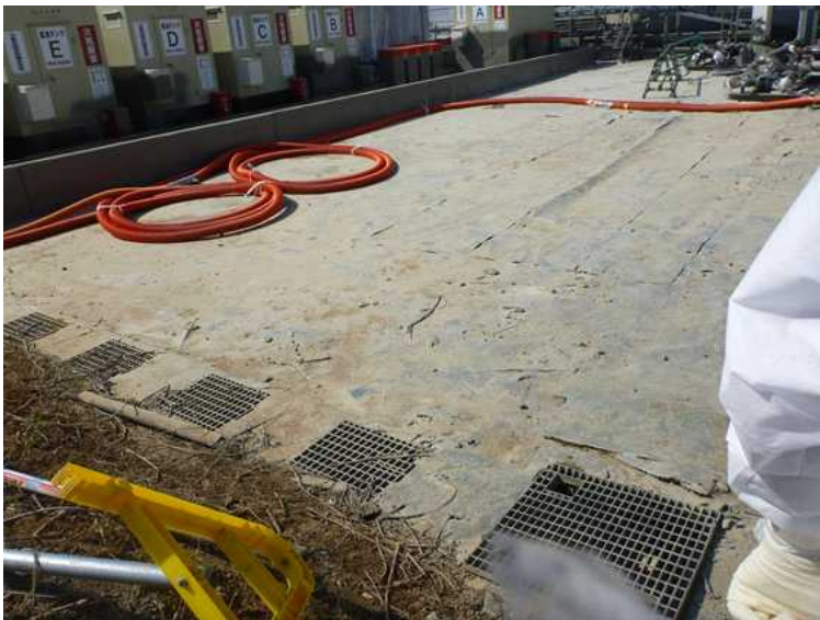
○ H6 タンクエリア 地下水観測孔 (G-2) 付近 の汚染水漏えい箇所
