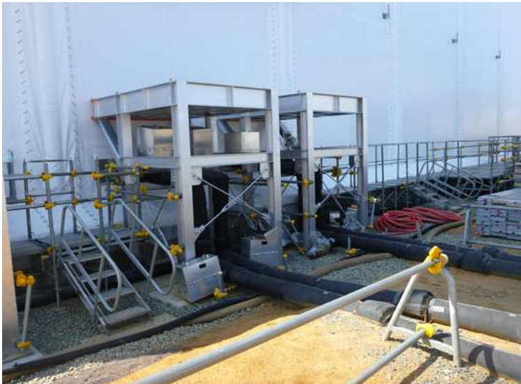
○多核種除去設備（ALPS） 移送配管（屋外）
