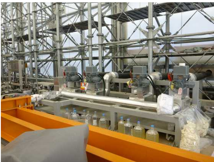
○多核種除去設備（ALPS） 移送配管（屋内）
