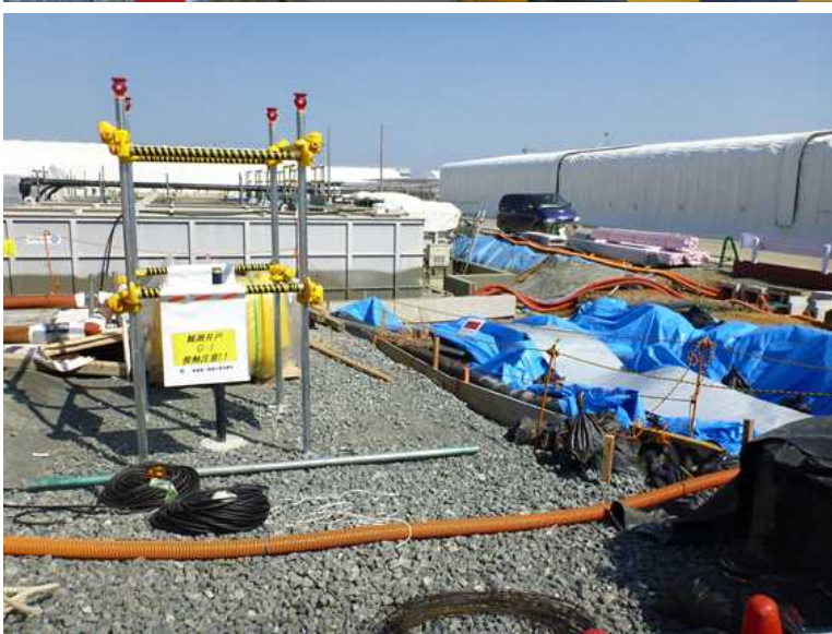
○ H6 タンクエリア 地下水観測孔（G-1）
