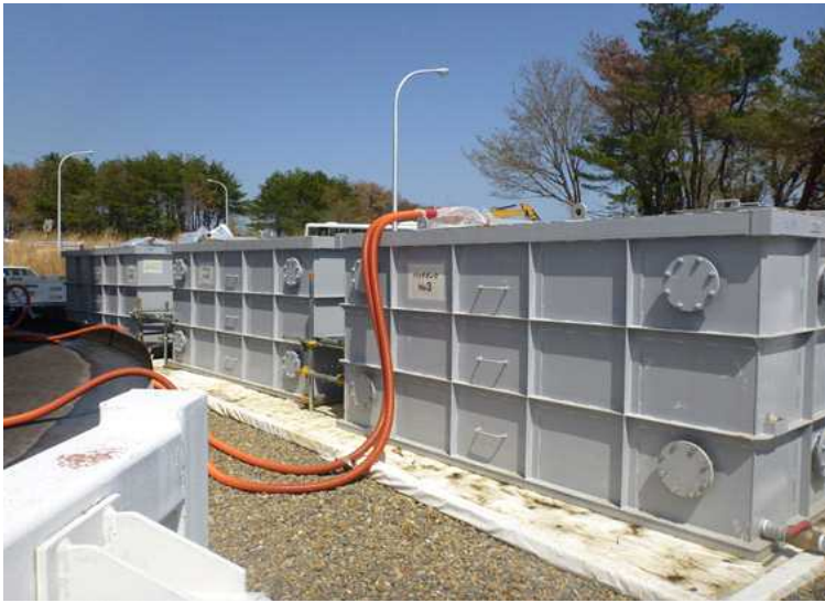
○ろ過水タンク付近に設置されている雨水移送用のノッチタンク
