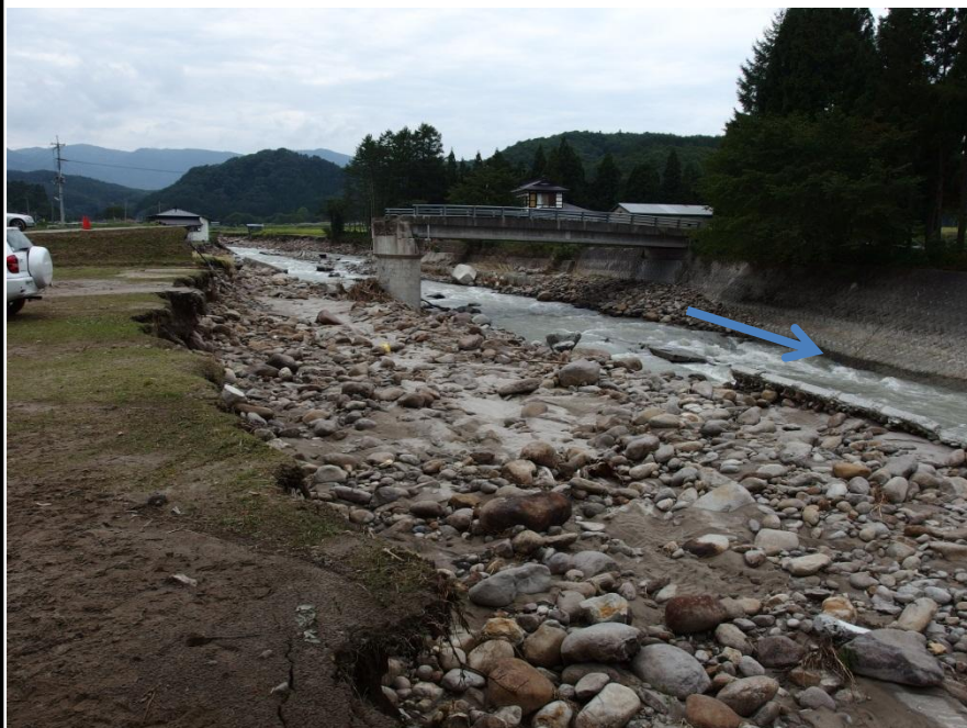
一級河川桧沢川の被災状況
