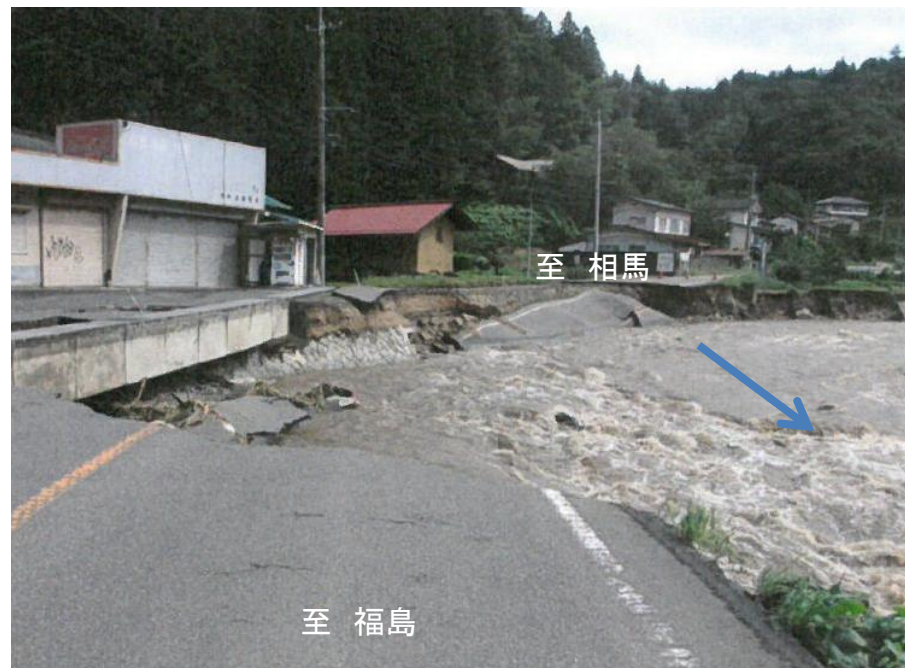
国道115号の被災状況
