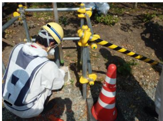
地下水観測井の確認
