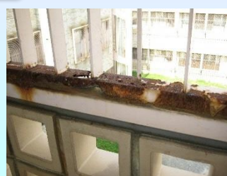
さび付いた転落防止柵
