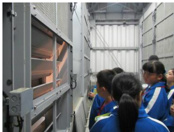
＜外気を取り入れる壁の様子＞
