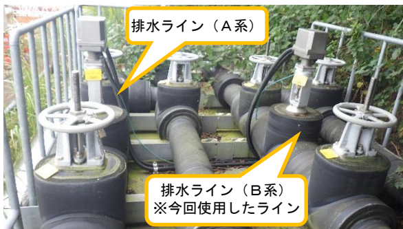
(写真2) サブドレン処理水排水経路のバルブユニットの状況
