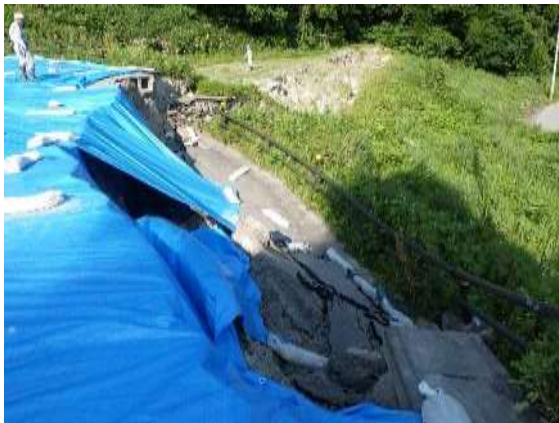
— 県道と農地の亀裂の状況 — (H30.6.3)
