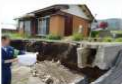
約1.3mの段差が発生
