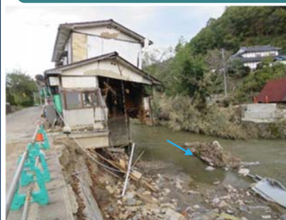
広瀬川（川俣町） 【台風19号による被災状況】
