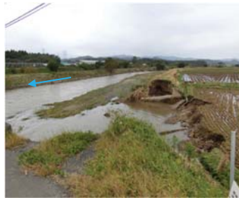
社川（棚倉町） 【河川堤防の被災状況】
