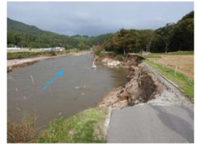
木戸川（川内村） 【河川護岸の被災状況】
