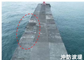
小名浜港（いわき市） 【港湾の被災状況】
