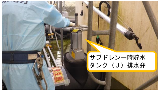
(写真3) サブドレン一時貯留タンク（J）排水弁開操作の状況
