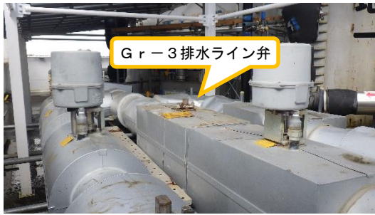
(写真1-2) Gr-3の排水ラインの弁の状況 「閉」となっている
