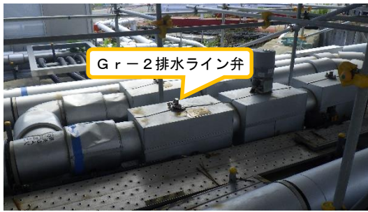
(写真1-1) Gr-2の排水ラインの弁の状況 「閉」となっている
