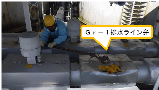
(写真1-3) Gr-1の排水ラインの弁開操作の 状況
