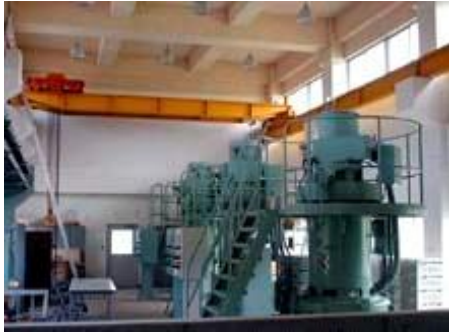
白沢揚水機(本宮市)
