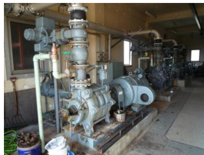
湯野揚水ポンプ（福島市）
