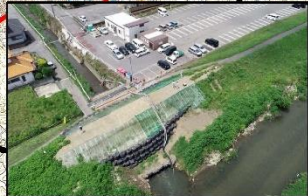
金子沢排水樋門(県:いわき建設) ポンプ施設整備(いわき市)
