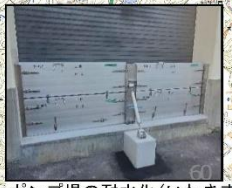
ポンプ場の耐水化(いわき市)
