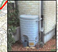
雨水貯留タンク(いわき市)
