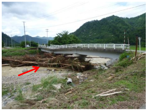
国道289号 花立橋(只見町) 【新潟・福島豪雨による橋梁損壊】
