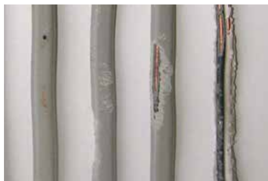
写真3 ネズミにかじられた 電気ケーブル
