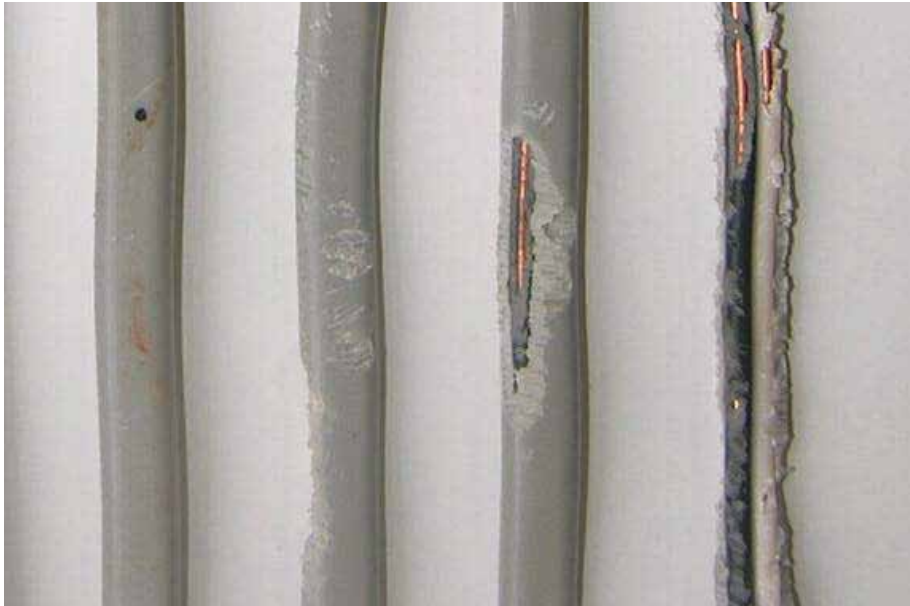
写真2 ネズミにかじられた電気ケーブル
