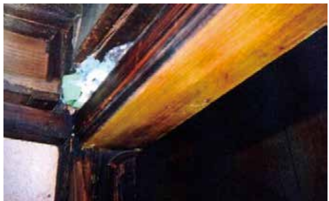
写真 22 天井裏の巣 放棄された巣からイエダニが下りてくることがありうる
