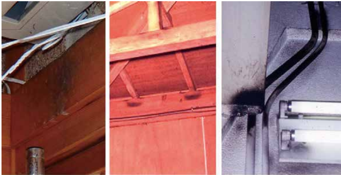
写真5 ネズミの通路跡
