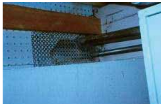
写真 19 金属板（パンチング板）による侵入防止
