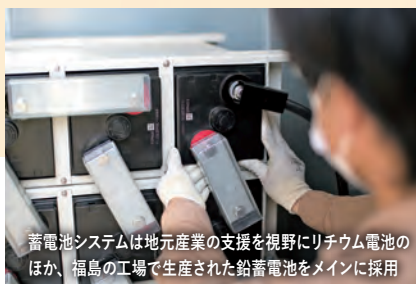
太陽光、蓄電池、LPガス発電機を組み合わせたサステナブル・エナジーソリューション
