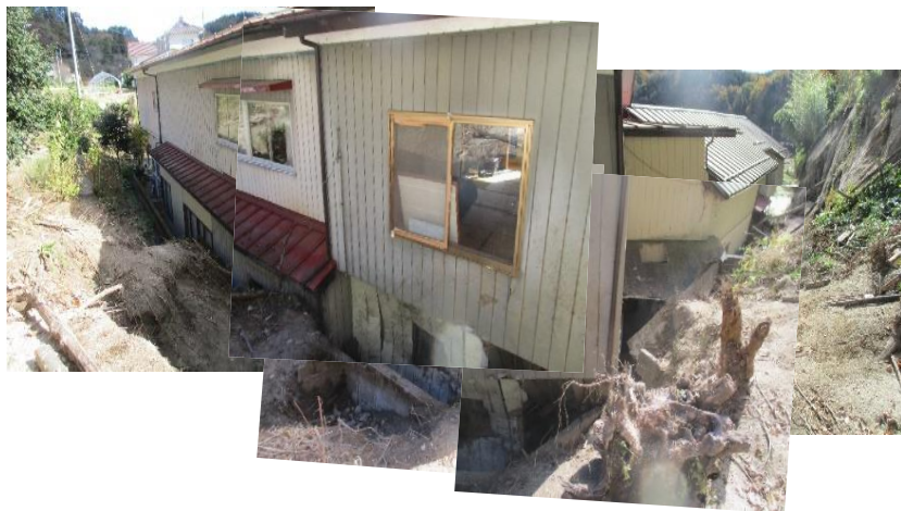
R1.10 東日本台風による崩落
