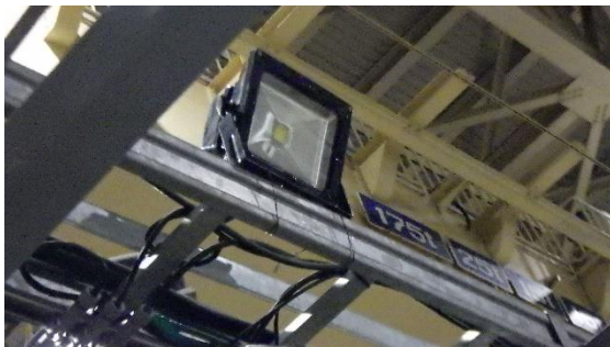
(写真2) 仮設の照明の状況
