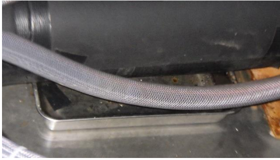
(写真1-1) 漏えい箇所下部に設置されている受けパンの状況
