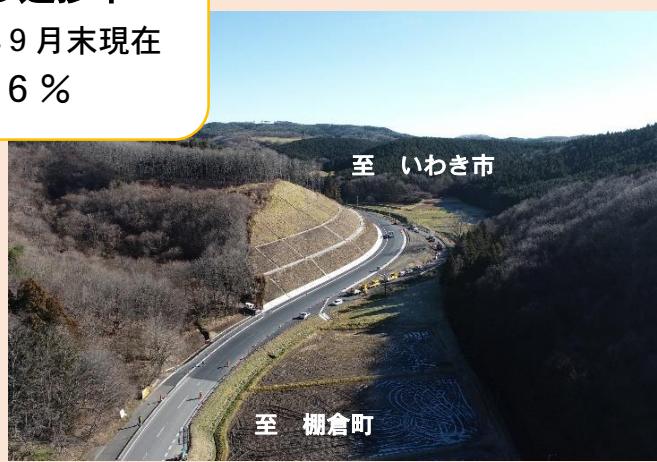
① 2工区 舗装完了箇所 (バイパス部の舗装を行いました)
