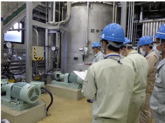
ループ設備の概要設備の様子
