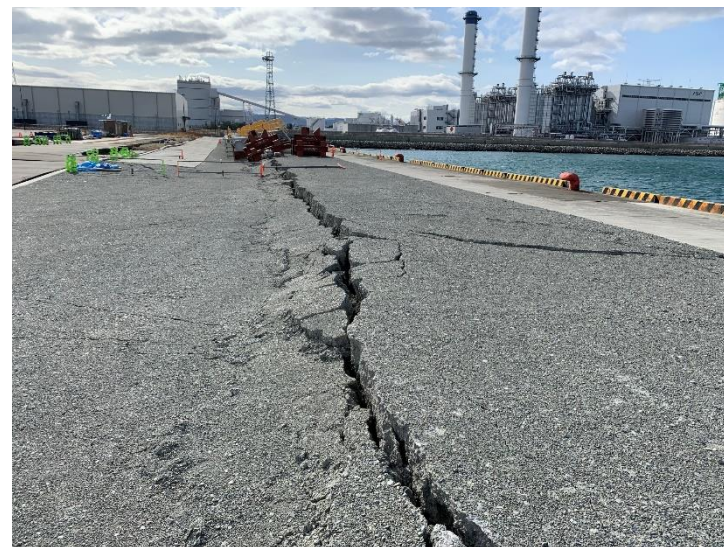
地震により生じた傾き・段差の復旧 相馬港3号ふ頭(新地町)
