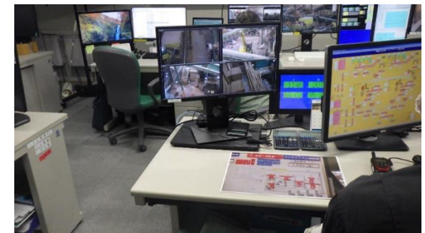
カメラによる場内の監視状況
