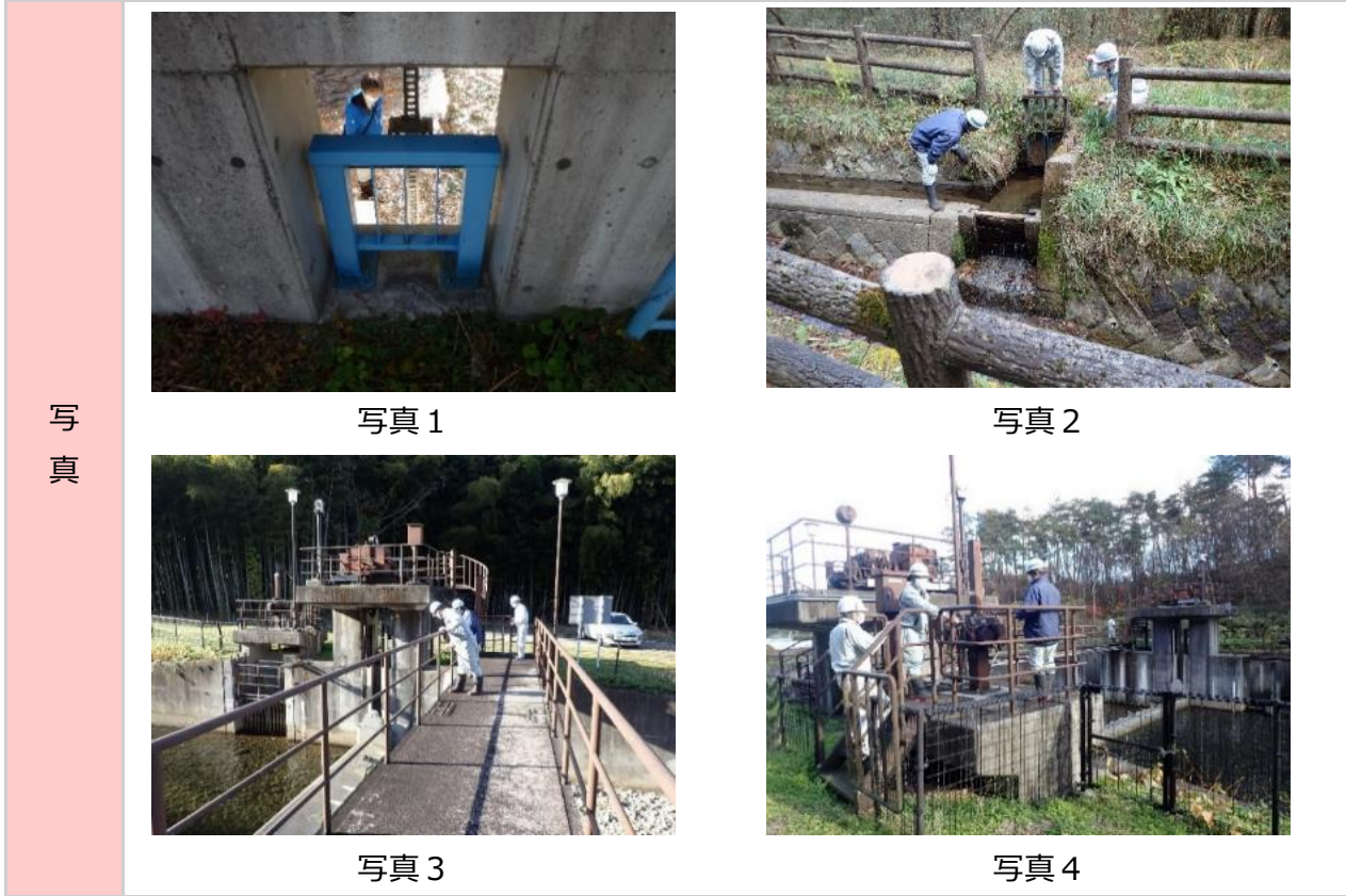
写真1 取水樋門の点検（福島市須川堰） 写真2 取水口の点検（二本松市吉倉新堀頭首工） 写真3 堰体の点検（二本松市油井川頭首工） 写真4 取水ゲートの点検（二本松市油井川頭首工）
