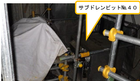
(写真5-2) サブドレンピットNo.40の状況 (南西側から撮影)
