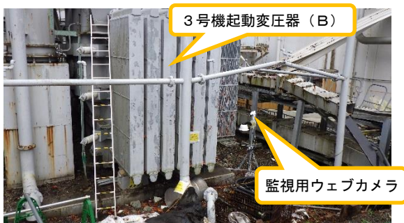
(写真4-1) 3号機起動変圧器 (B) の状況 (北西側から撮影)
