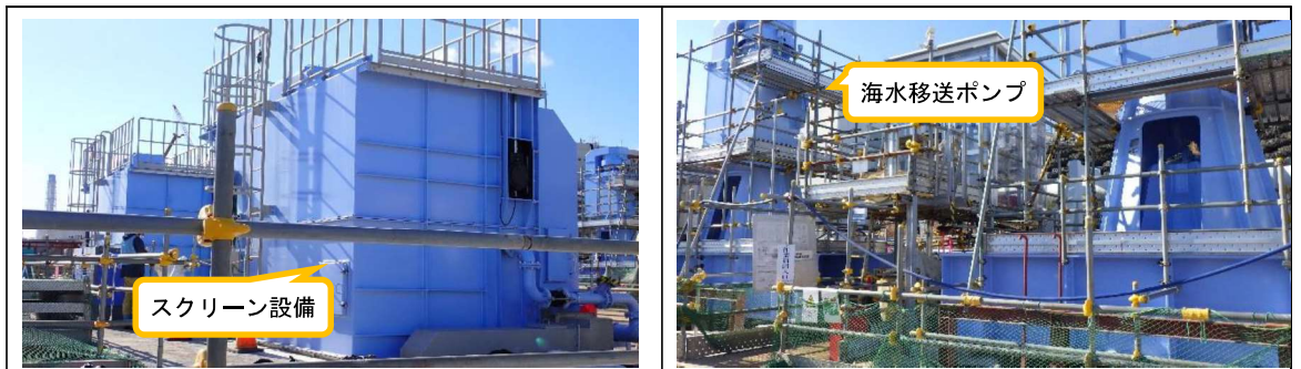
(写真1-1) 新設されたスクリーン設備
