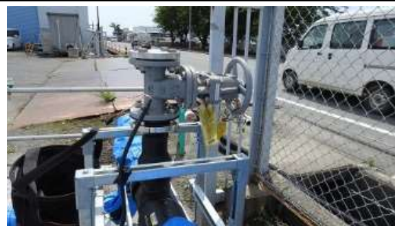
(写真1) ALPS 処理水移送配管ベント弁
