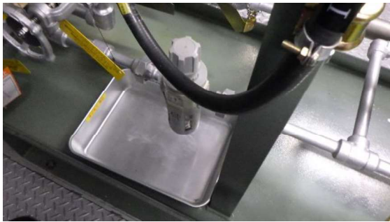
(写真4-4) A系焼却炉バーナーユニット防液堤の状況
