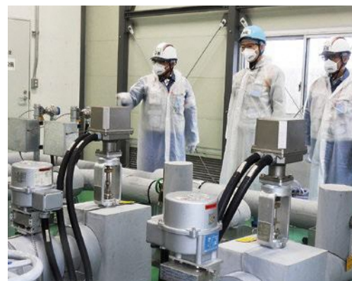
緊急遮断弁を確認する様子
