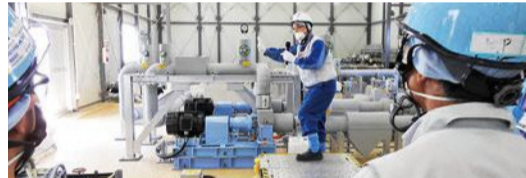
ALPS処理水移送ポンプの確認状況
