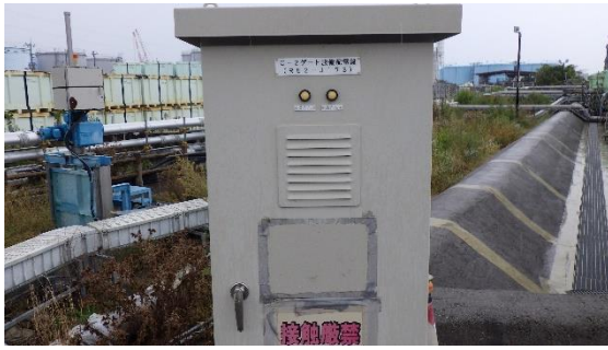
(写真 2 - 2) 排水路関連設備 (ゲート設備配電盤) の一例
