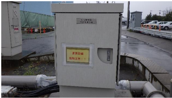
(写真 2 - 3) 排水路関連設備 (P S F 測定部盤) の一例
