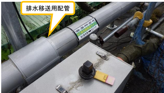
(写真3-3) 電動開閉ゲート（BC-1）に設置 されている排水移送用配管の状況
