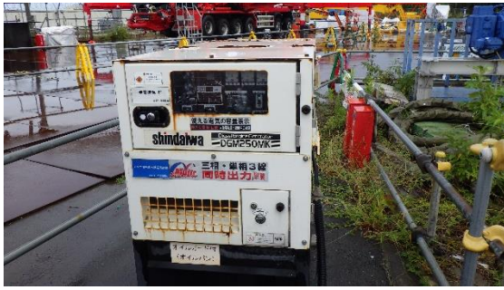
(写真3-2) 電動開閉ゲート（BC-1）に設置 されている発電機の状況
