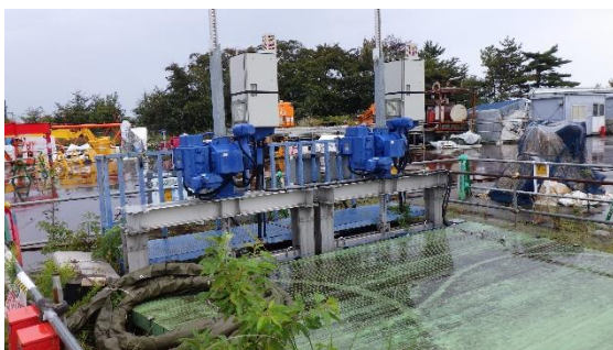
(写真 3 - 1) 電動開閉ゲート (BC - 1) の状況
