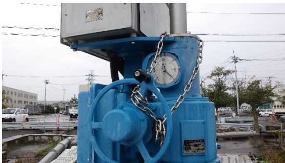
(写真2-1) 電動開閉ゲートの一例
