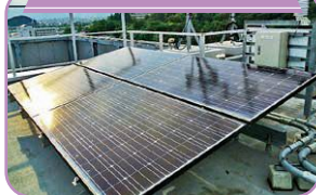
屋上の太陽光パネル
