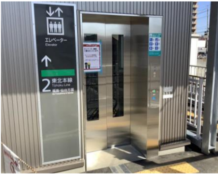
(エレベーター)
