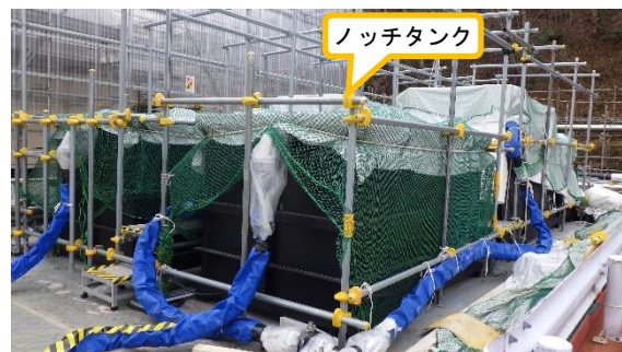
(写真5-2) 中継タンク西側の揚水配管洗浄装置 の設置状況② (北西側から撮影)
