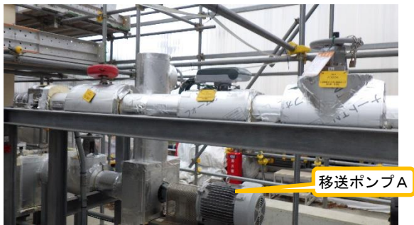
(写真4-3) 移送ポンプA回りの配管の状況 (南西側から撮影)
