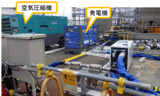
(写真5-1) 中継タンク西側の揚水配管洗浄装置 の設置状況① (北西側から撮影)
