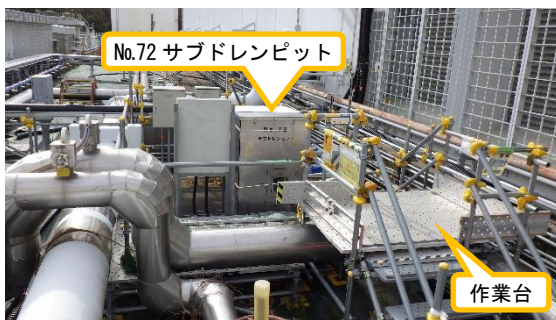
(写真1-1) 点検用作業台の設置例 (No.72サブドレンピット) (北側から撮影)
