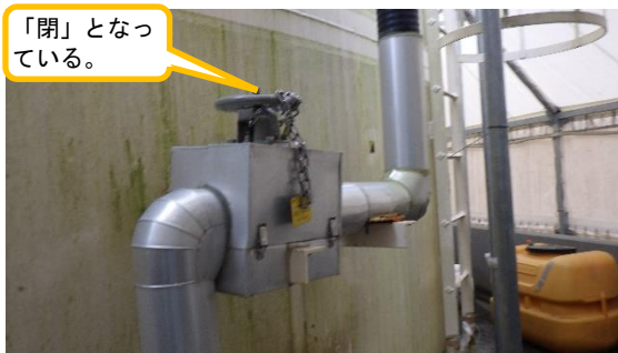
(写真3) N1タンクの入口弁
