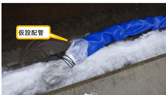
(写真5) N1タンクに設置されていた仮設配管末端の状況
