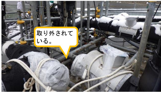
(写真2) 移送ポンプ出口配管
