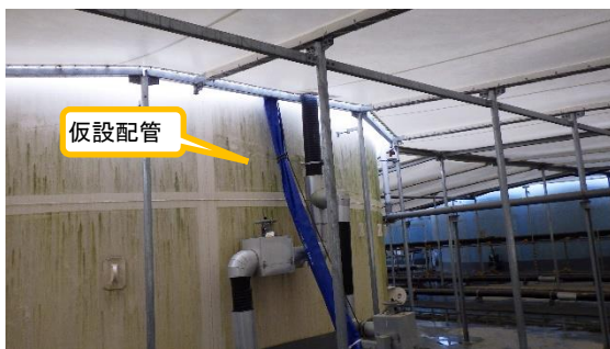
(写真4) N1タンクに設置されていた仮設配管
