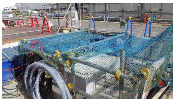
(写真2) K排水路への入口の状況(閉鎖されていた)
