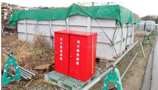
(写真1－1) 消火用タンク及び消火器の設置状況
