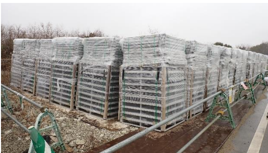
(写真 1 - 5) エリア東側（道路沿い）における瓦礫保管用コンテナの仮置き状況
