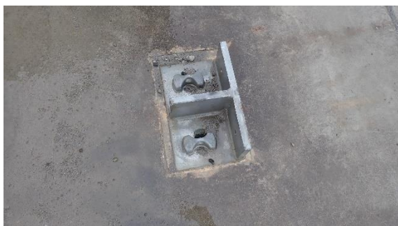
(写真5-3) コンクリート基礎上に設置された保 管用コンテナの固定金具
