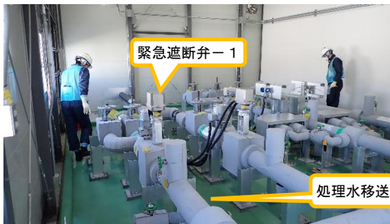
(写真 3 - 2) 処理水移送設備移送配管等の確認状況 (5, 6号機東側電気品建屋内の西側から撮影)
