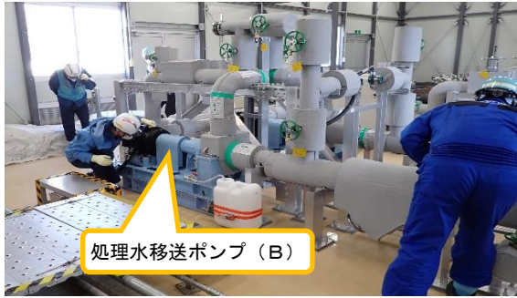
(写真 3 - 1) 処理水移送ポンプ (B) の確認状況 (多核種移送設備建屋内の北東側から撮影)
