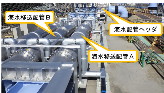
(写真 1 - 3) 海水移送配管等の状況 (南東側から撮影)
