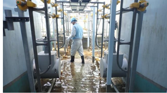
(写真3-2) 変位が確認され、取り外された連結管の例 (今回撮影)
