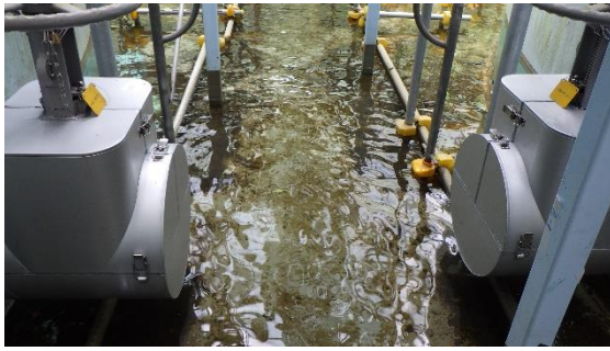
(写真3-1) 変位が確認され、取り外された連結管の例 (令和4年7月29日撮影)
