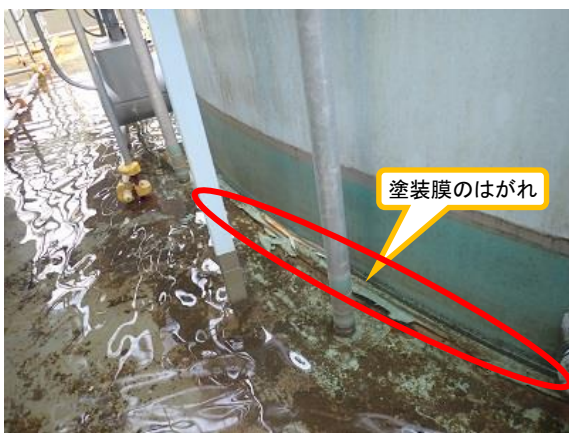
(写真2) タンク下部周囲の防水塗装はがれの 状況
