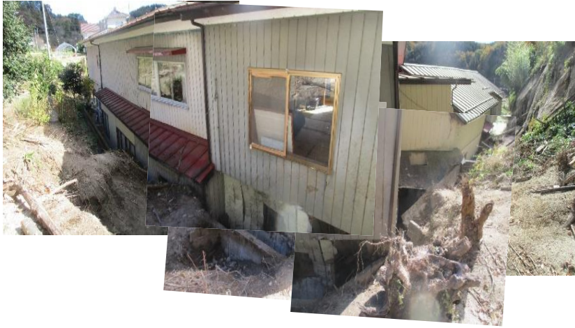
R1.10 東日本台風による崩落
