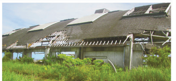
津波によって崩壊した県水産種苗研究所の跡
