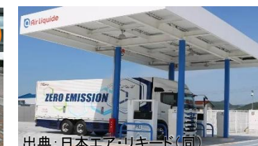
本宮インターチェンジ 水素ステーション 出典：日本エア・リキード(同)
