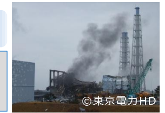
水素爆発を起こした直後の3号機
